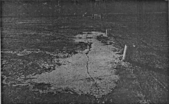
25. Fisura en placa de entpiso
