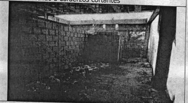
19. Obra abandonada. Lo cual ha generado el depósito de basuras
