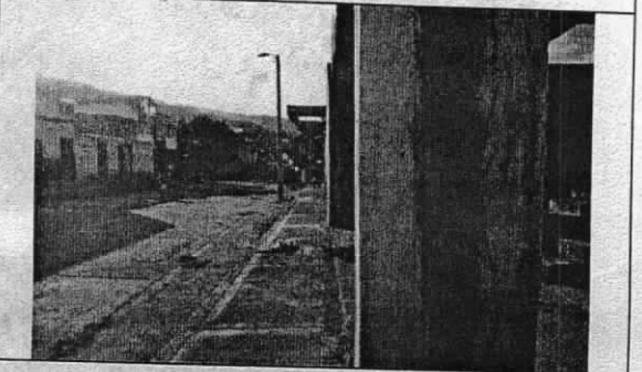
20. Columnas no alineadas en paramento
